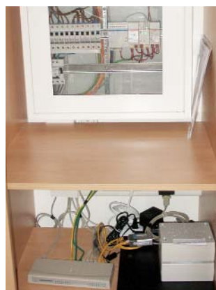
Auch Technik braucht Platz. Steuergeräte und Schaltschrank mit EIB-Komponenten Technics also need to be stored properly. Control units and control cabinets with EIB components.
